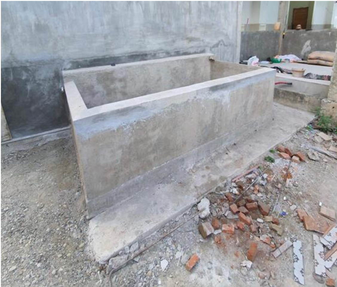
Gambar 10. Bak Penampungan Air
